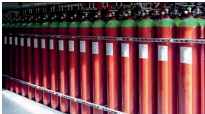
CO2 Fire Suppression System ◀
